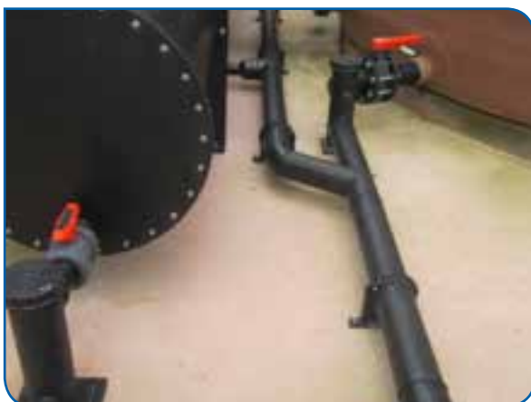
AFSLUITER SPOELWATER AFVOER
