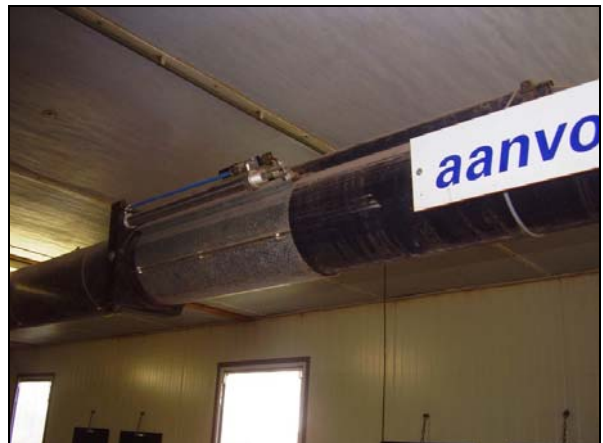
K. Stortklep in de stroleiding boven een kraamhok
