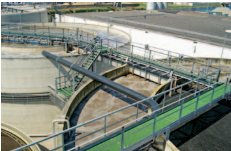
Conventioneel nitrificatie/denitrificatie systeem omgebouwd tot NAS ® bij aardappelverwerker Lamb Weston Meijer, Bergen op Zoom.
