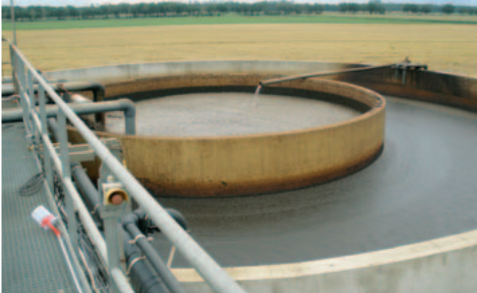
NAS ® systeem voor digestaatzuivering Ecofuels, Well (Limburg).
