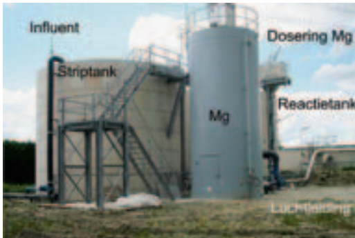
Full scale ANPHOS®-installatie bij LWM Krui-ningen
