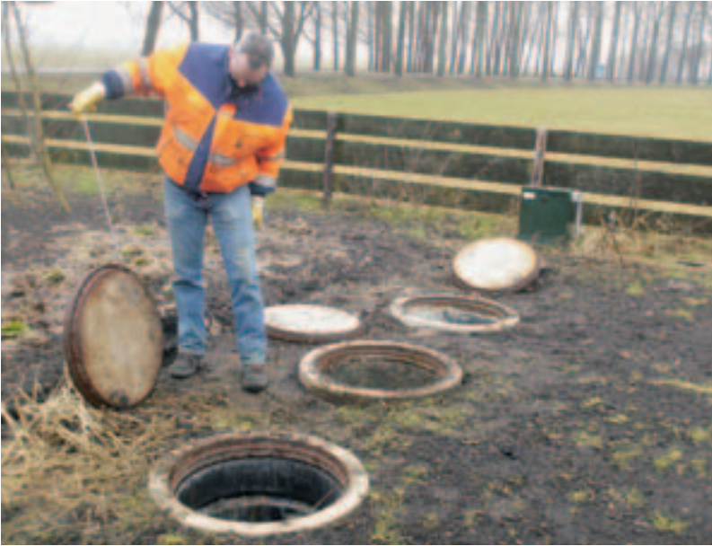
Onderhoud aan IBA door medewerker HHNK.
