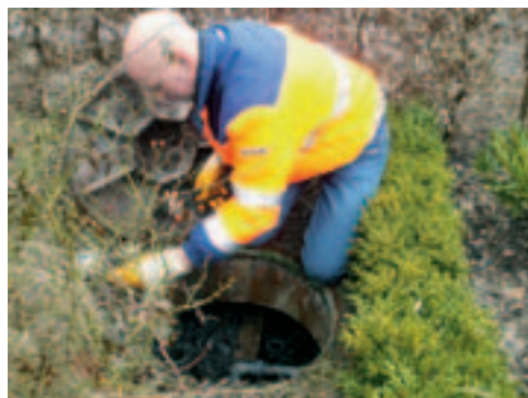
Onderhoud aan een IBA.
