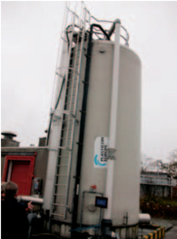
Tank geschikt voor co-producten De Nieuwe Waterweg.
