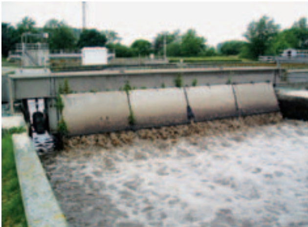
Een borstelbeluchter van de rwzi Bennekom.
