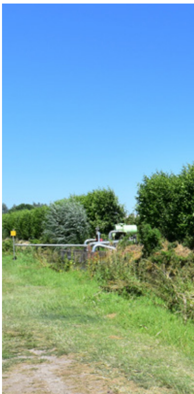
De pomp en de buizen van het fertigatiesysteem.
