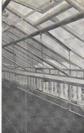
Luchtmechanisme met hangtabletten, kweekkas met spantverwarming
