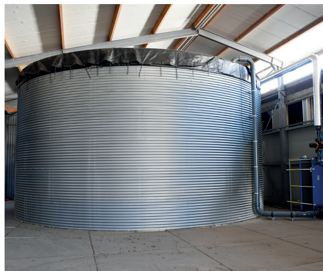
De geïsoleerde silo voor warm water met warmtewisselaar.
