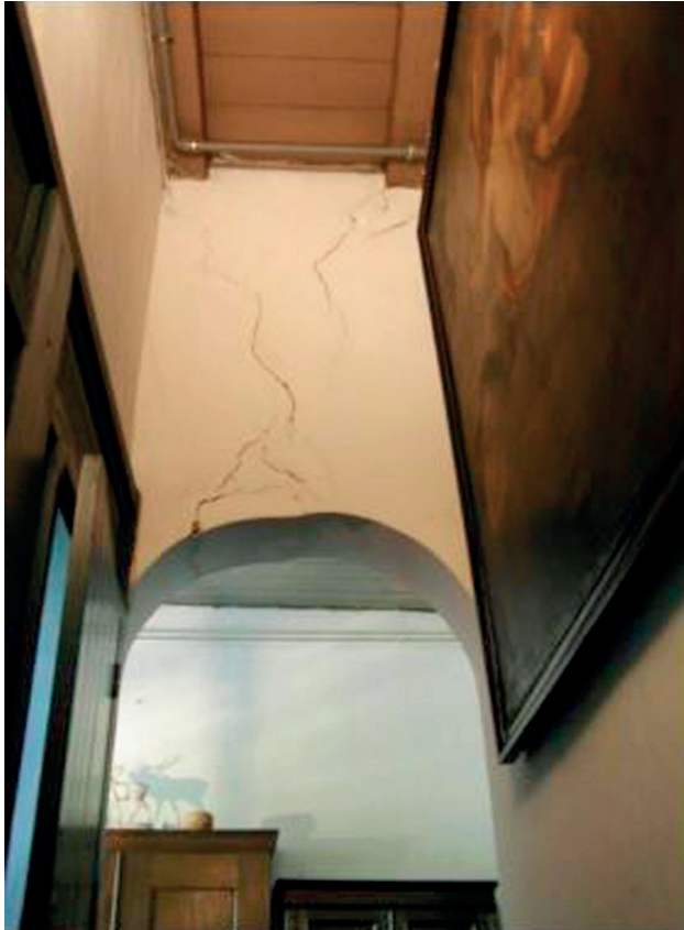
Afbeelding 1: Scheurvorming in monumentaal pand (bron Constructiebureau De Prouw)
