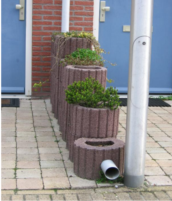
Foto 11. Hemelwaterafvoer via een plantenbak naar de straat
