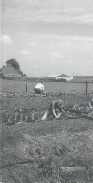
De laatste fase in de aanleg van een helofytenfilter: per vierkante meter worden drie jonge rietplantjes gepoot
