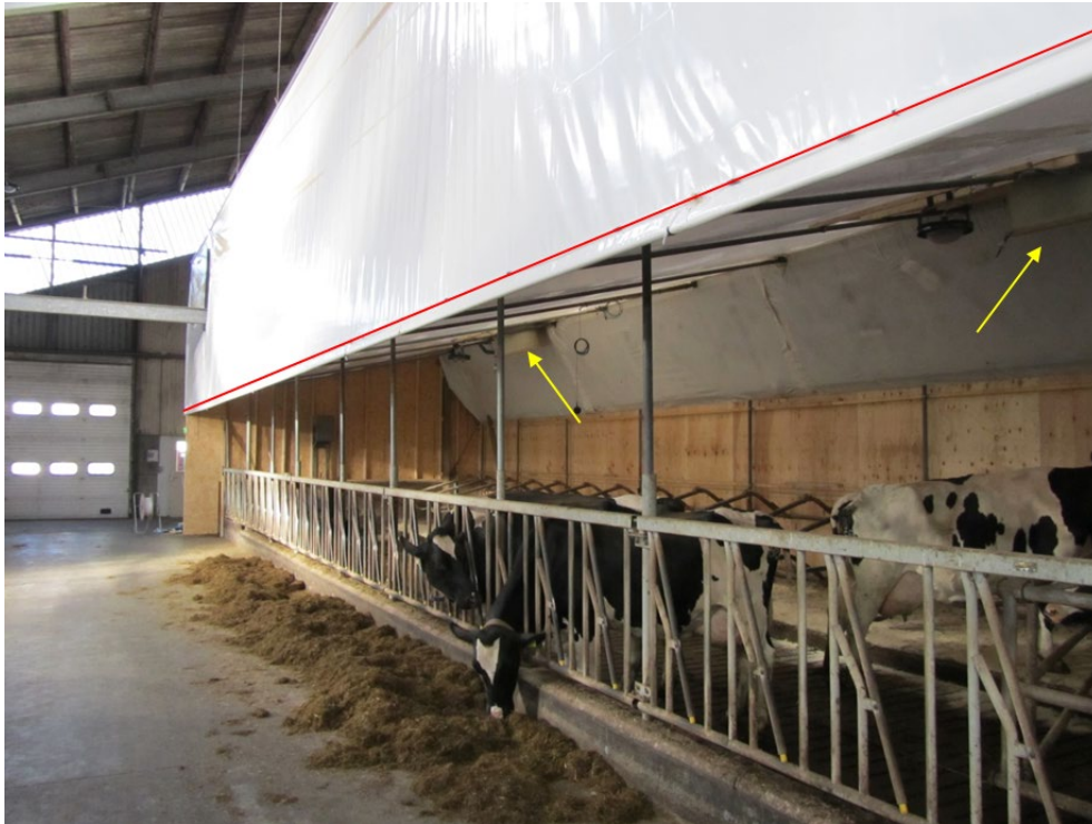
Figuur 2 Zicht op afdeling 16 van de meetunit. Het gordijn voor regeling van de luchtinlaat is omhoog. Aan de onderzijde van het gordijn zijn de meetpunten voor meting van de achtergrondconcentratie bevestigd (rode lijn). In de afdelingen zijn de twee ventilatoren voor de luchtafvoer te zien (gele pijlen) waarin zich ook de monsterpunten voor de meting van de ammoniakconcentratie in de uitgaande lucht bevinden.
