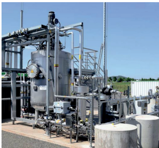
P2G INSTALLATIE MICROENERGY
