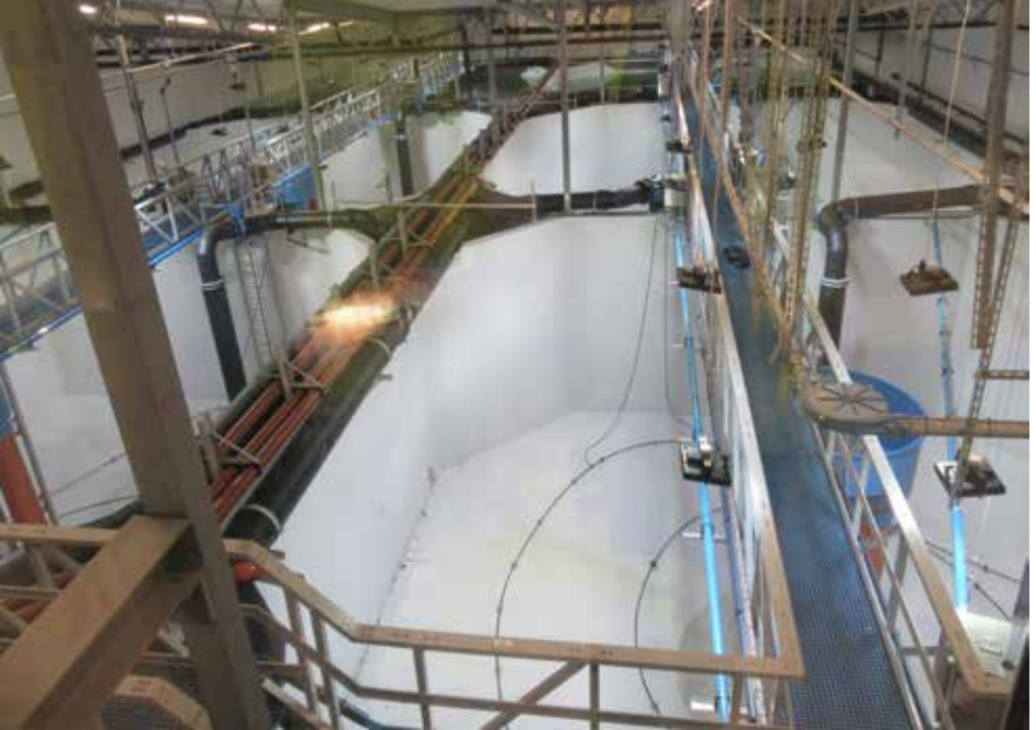
Het derde en grootste systeem, bestaande uit twee hallen met 6 tanks van 780 kubieke meter per stuk.
