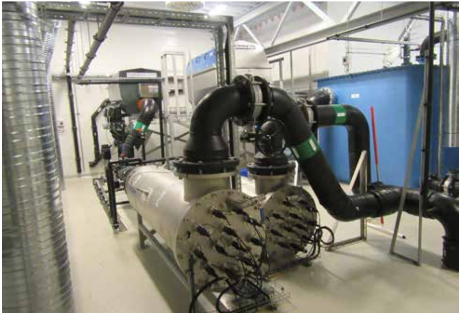
De UV units en daar achterliggend trommelfilters en ozon voor de behandeling van het inkomende bronwater.
