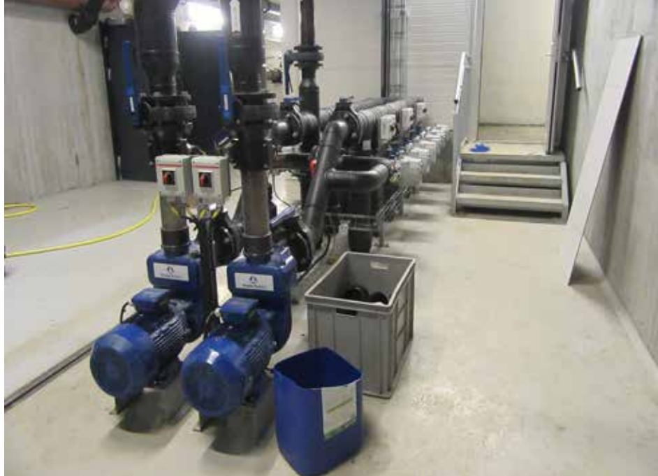
De kleppen onder het biologisch filter om opgehoopt vuil af te voeren.
