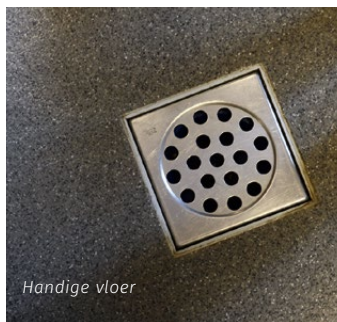
Water uit het plafond
