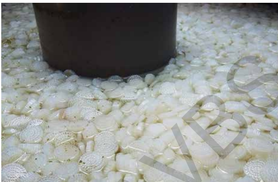
Dragermateriaal binnenin de MBBR
