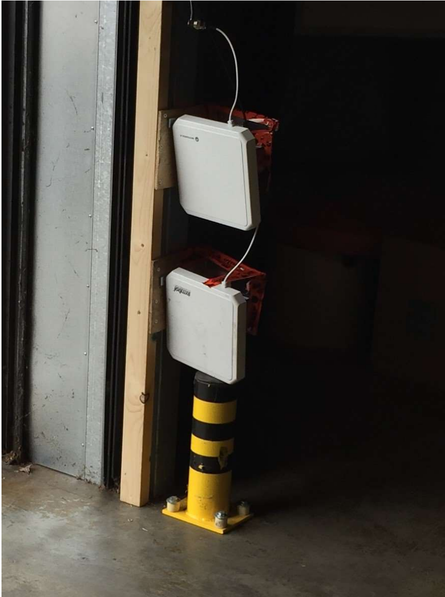
Afbeelding 3. Antennes van de Portal bij de proefopstelling
