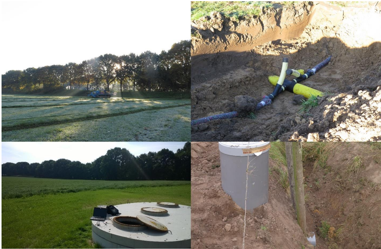
Figuur 2-5: Foto's van het systeem voor subirrigatie. Linksboven: Sleufloze aanleg van de drainage/infiltratiebuizen. Rechtsboven: verzamelleiding (geel) met daarop aangesloten drainage/infiltratiebuizen en controle/doorspuitstukken. Linksonder: aanvoerput/reservoir waarop zowel de aanvoerleiding vanuit Bavaria (in) als de verzamelleiding (uit) is aangesloten. Rechtsonder: Eindput met afvoer op de sloot. Deze voert alleen water af als de waterstand hoger is dan de ingestelde overstorthoogte. Dit is het geval bij overmatige neerslag, of bij drainage in de winterperiode (zonder wateraanvoer).
