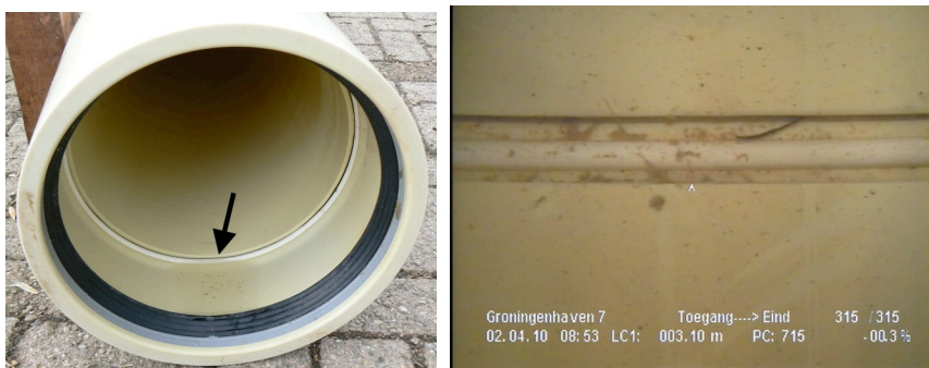
Afbeelding 3. Links: foto van de binnenkant van een 315 mm pvc verbinding De spleet is aangeduid met de pijl. Rechts: onderwaterfoto van de binnenkant van dezelfde pvc verbinding met een CCTV camera.
