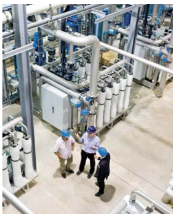
Afbeelding 1. De 1400 m 3 /uur full-scale demiwaterinstallatie (DWP) in de Botlek van Evides Industriewater
