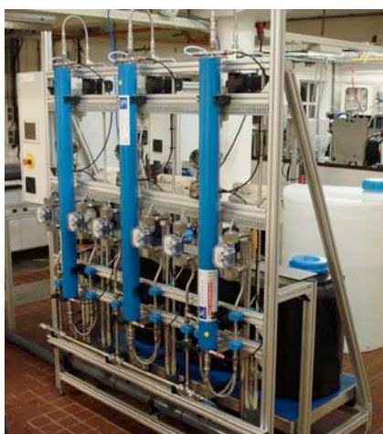
Afbeelding 2. AiRO-opstelling met drie parallelle 2,5 inch SWM RO-elementen bij KWR
