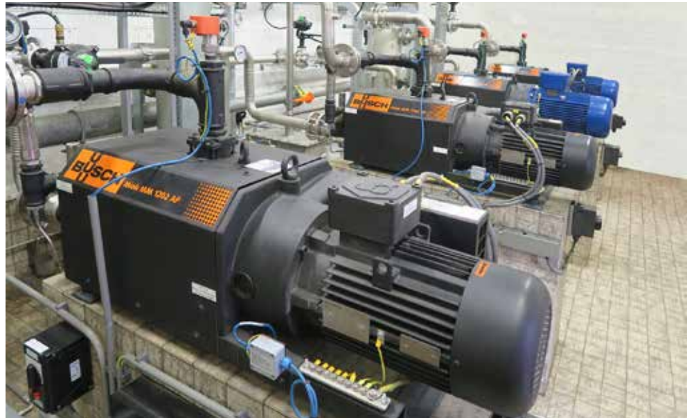
Vier nieuwe compressoren draaien zonder noemenswaardig onderhoud
