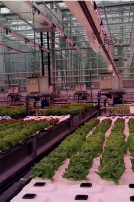
Figuur 35 Boven het rechtse bassin waren LED-armaturen met verrood geïnstalleerd. Deze waren aan één kant afgeschermd met zwart/wit folie om beïnvloeding van de sla in de andere bassins te voorkomen.
