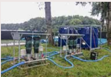
Mobiele pompstations voor drinkwater
