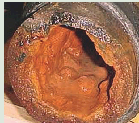
Aanslag in de leidingen
