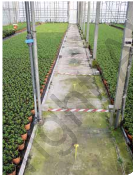
▲ Groene aanslag op betonpad (vergelijkende proef met biociden)
