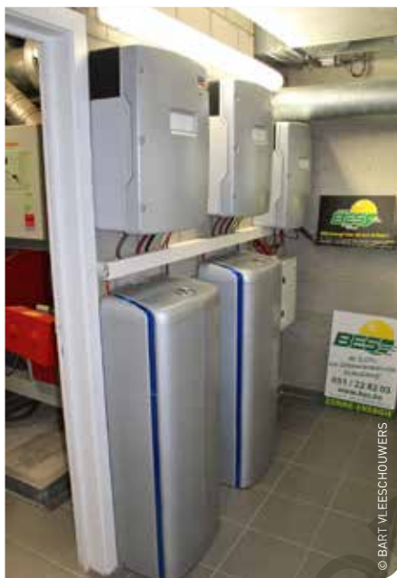
De batterij-installatie bij Inagro. Onderaan de batterijen, bovenaan de omvormers.
