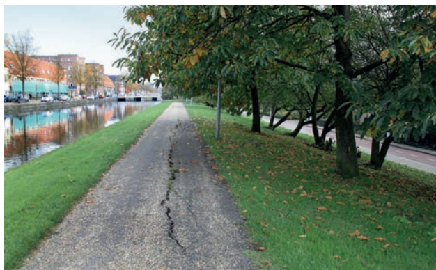
afb 7. Scheuren in wegdek Ringdijk bij bomen in het talud nabij Eenhoorn
