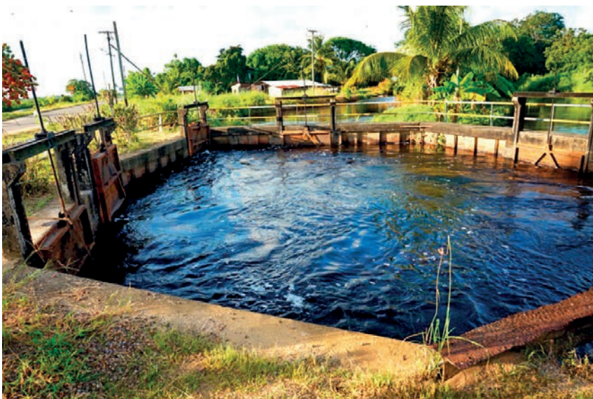
Afbeelding 4. Waterverdeelwerk bij Claragemaal met achterstallig onderhoud
