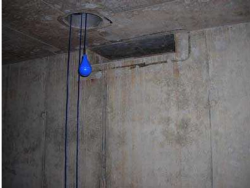
Figuur 13 Overloop van een drinkwaterreservoir met hoogniveaumeting.
