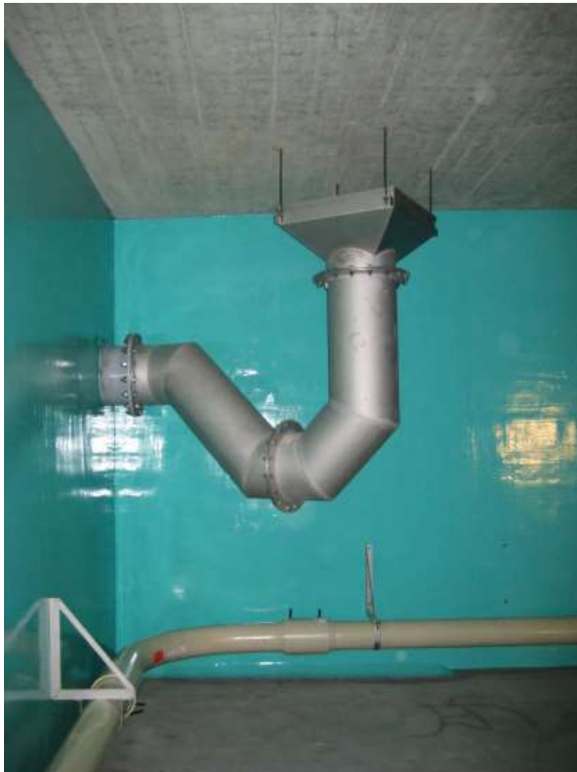
Figuur 11 Voorbeeld van een toevoerleiding (bovenste).
