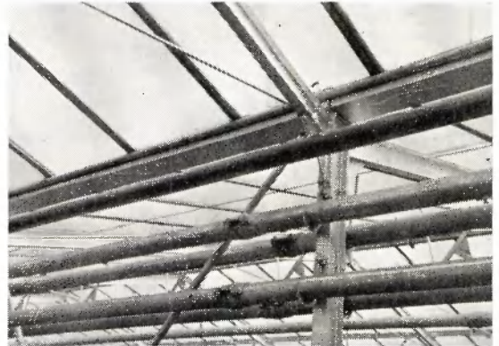
Afb. 4. Detail van foto 3. Goot voor afvoer van condenswater, verzinkte spantbenen, die met bouten aan de staanders zijn bevestigd, en snelkoppelbuizen, die in de winter als verwarmingspijpen dienst doen
