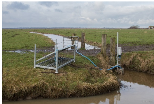
Figuur 3 Pomp op zonne-energie.
