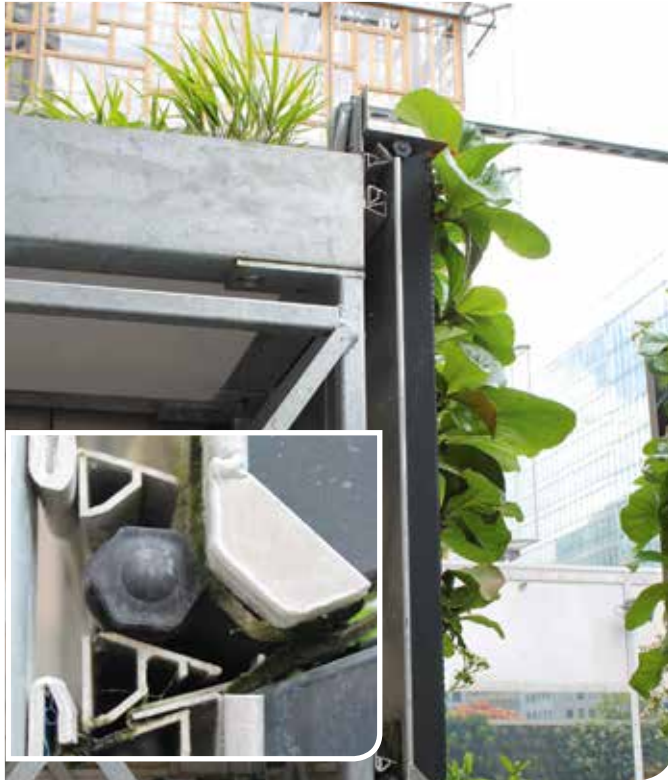
De aluminium ophangrails zijn voorzien van een geleiding voor de bevoeiingslangen.
