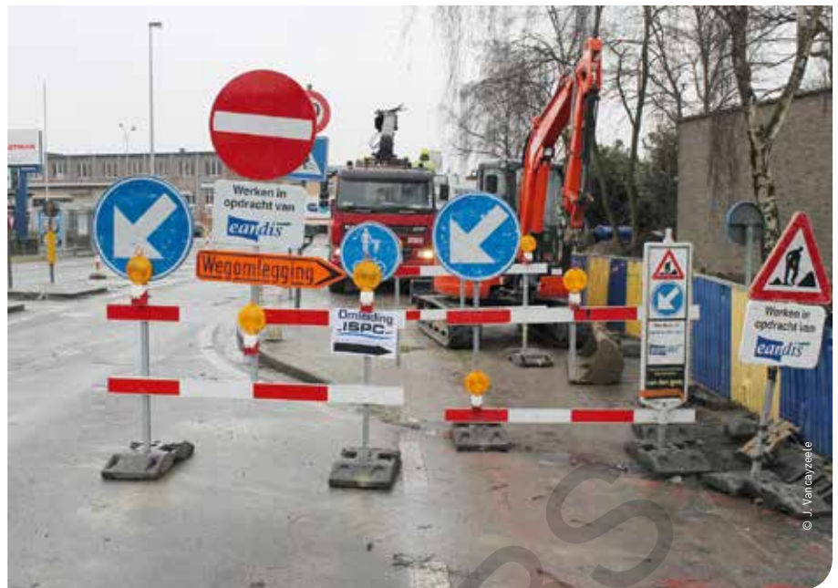
Signalisatie bij openbare werven is verplicht maar mag pas worden aangebracht als daartoe toelating is gegeven. Hiertoe dient een signalisatieplan van de werf te worden opgemaakt.
