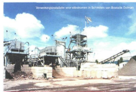
De installatie in Schiedam die onder meer rioolslib verwerkt tot herbruikbaar zand.
