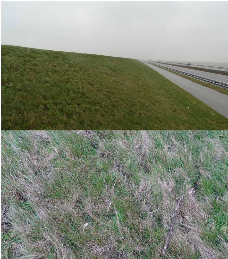
Foto 21: overzicht en detail proefvak 17.
