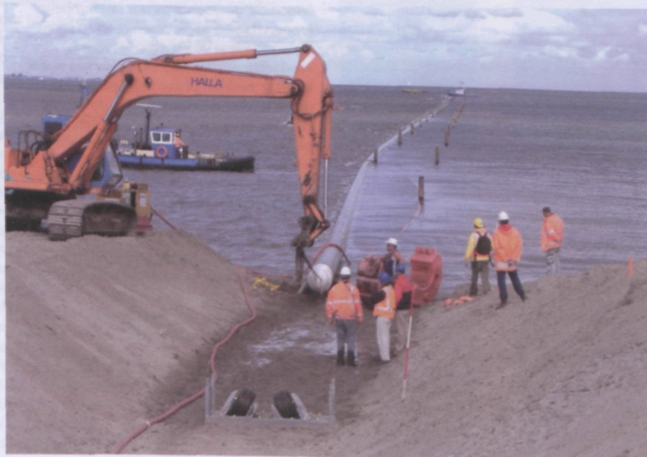
De 'aankomst' van de drinkwaterleiding uit het IJsselmeer.
