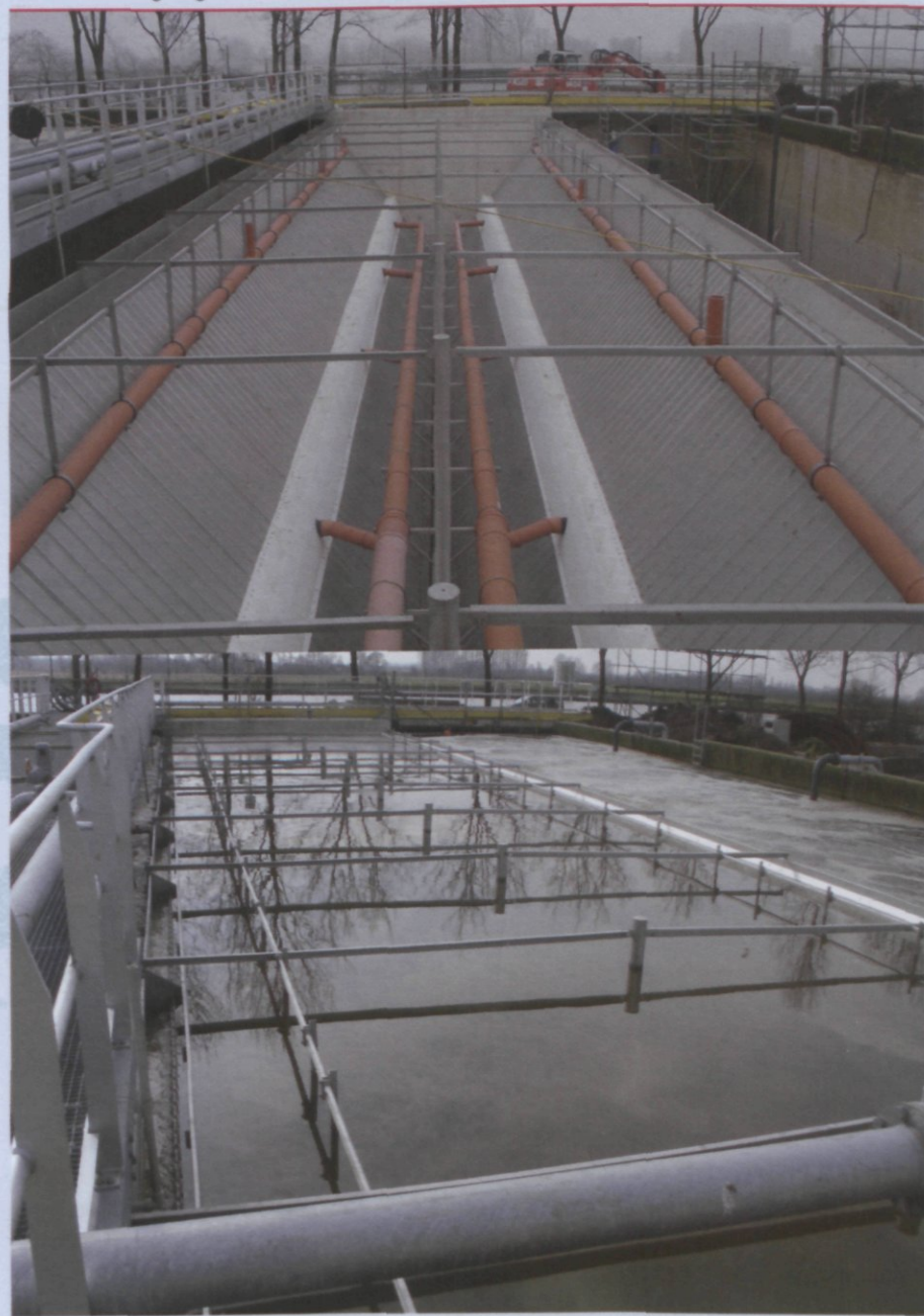
De USBF in een lege en gevulde aërietank.
