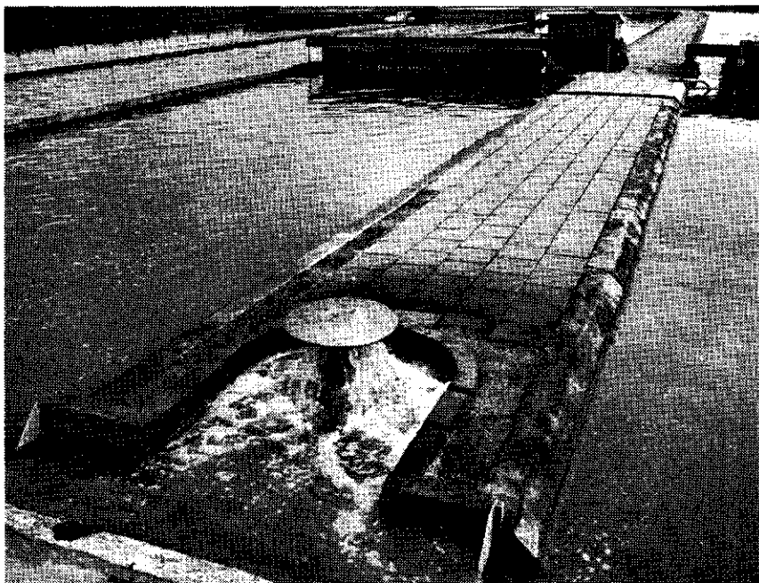
Afb. 7 - Invoerconstructie voor het afvalwater te Opmeer. Op de voorgrond wordt het verdeeld over de binnenste en de buitenste oxydatiesloot. Deze constructie doet tevens dienst als meetvoorziening.
