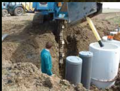
Aanleg van een diepgelegen systeem voor peilgestuurde drainage in Zeeland. Onderzocht wordt of diepgelegen drainage de nitraatbelasting op het oppervlaktewater kan verminderen (foto: provincie Zeeland)
