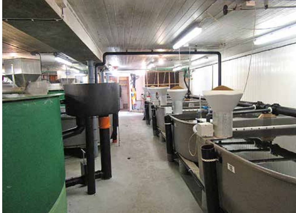
Een deel van de ruimte waar de eerste voeding plaats vindt.
