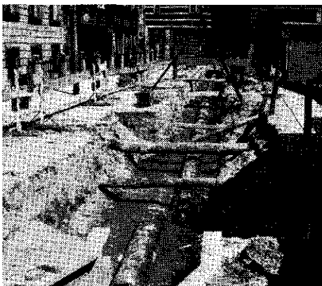
Aanleg van de stadsverwarming. Op de voorgrond is een betonnen put zichtbaar. Dwars over de put zijn buizen en kabels van andere leidingnetten zichtbaar.
