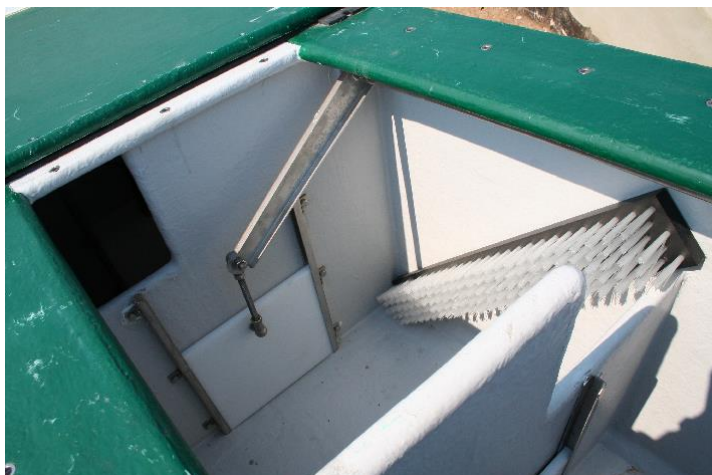
Afbeelding 3.1 Zicht op het binnenwerk van de hevelvistrap te Berghem, met een compartimentsschot met optrekbaar onderhoudsluik en een borstel in de wand ten behoeve van kruipende en slecht zwemmende vissen en macrofauna
