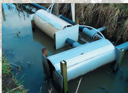
Installatie voor het continu meten van de greppel- en drainafvoer
