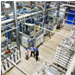
In Botlekgebied gebruikt Evides Industrierwater een innovatieve methode (AiRO) voor het reinigen van RO-membranen. Enkele minuten per week borrelt een lucht/waterspoeling omhoog en maakt de membranen schoon
