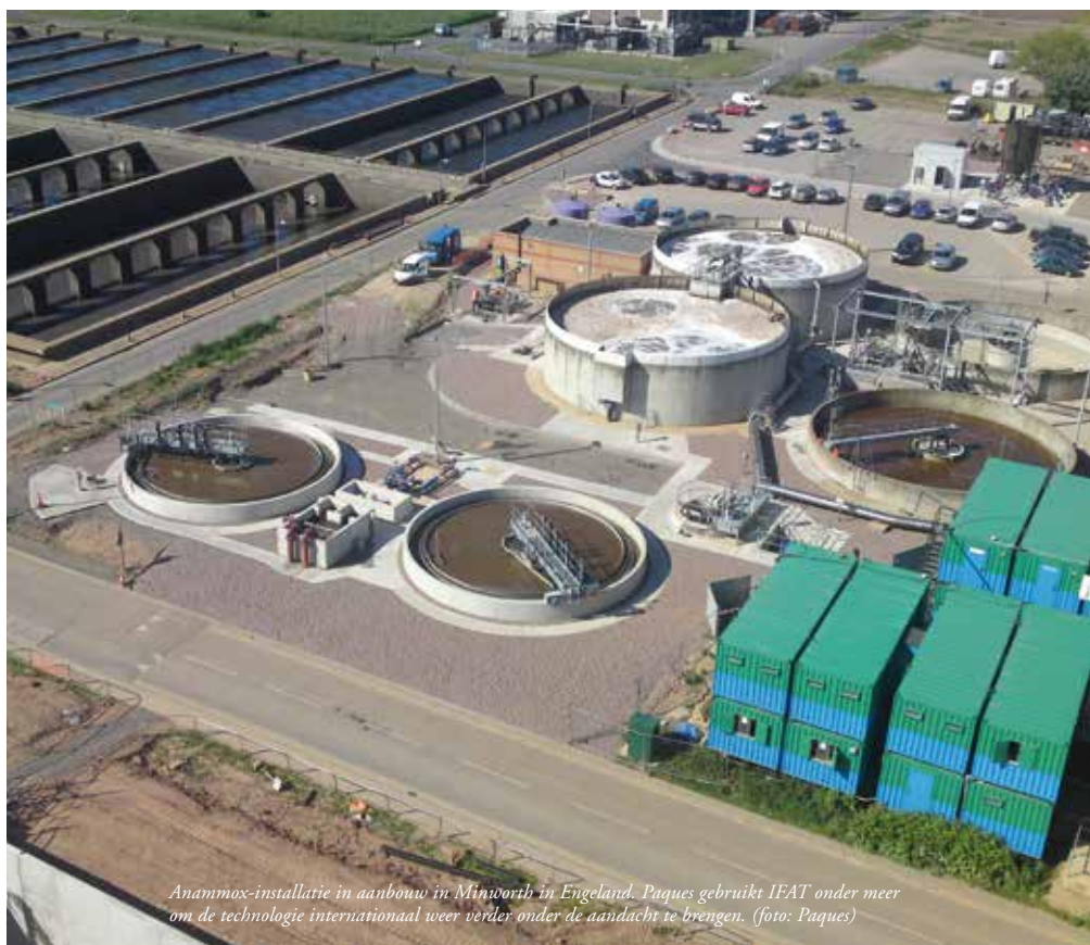
Installatie van een Nijhuis DAF-unit op de afvalwaterzuivering van de stad Ajaccio op Corsica. (foto Nijhuis)
