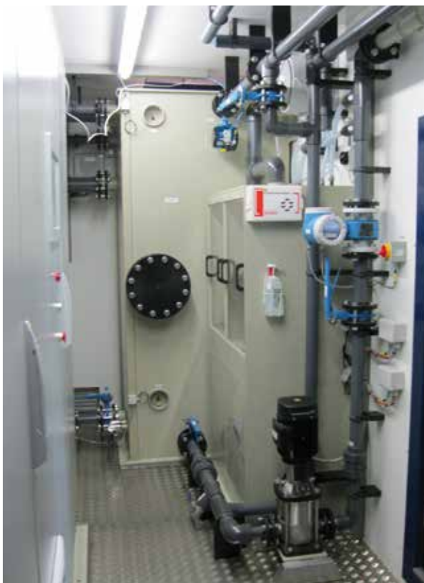
Doseerunit voor chemicaliën (links) en een zij-aanzicht van de UF-module bij de 'Puur Waterfabriek' (foto's: IOI)
