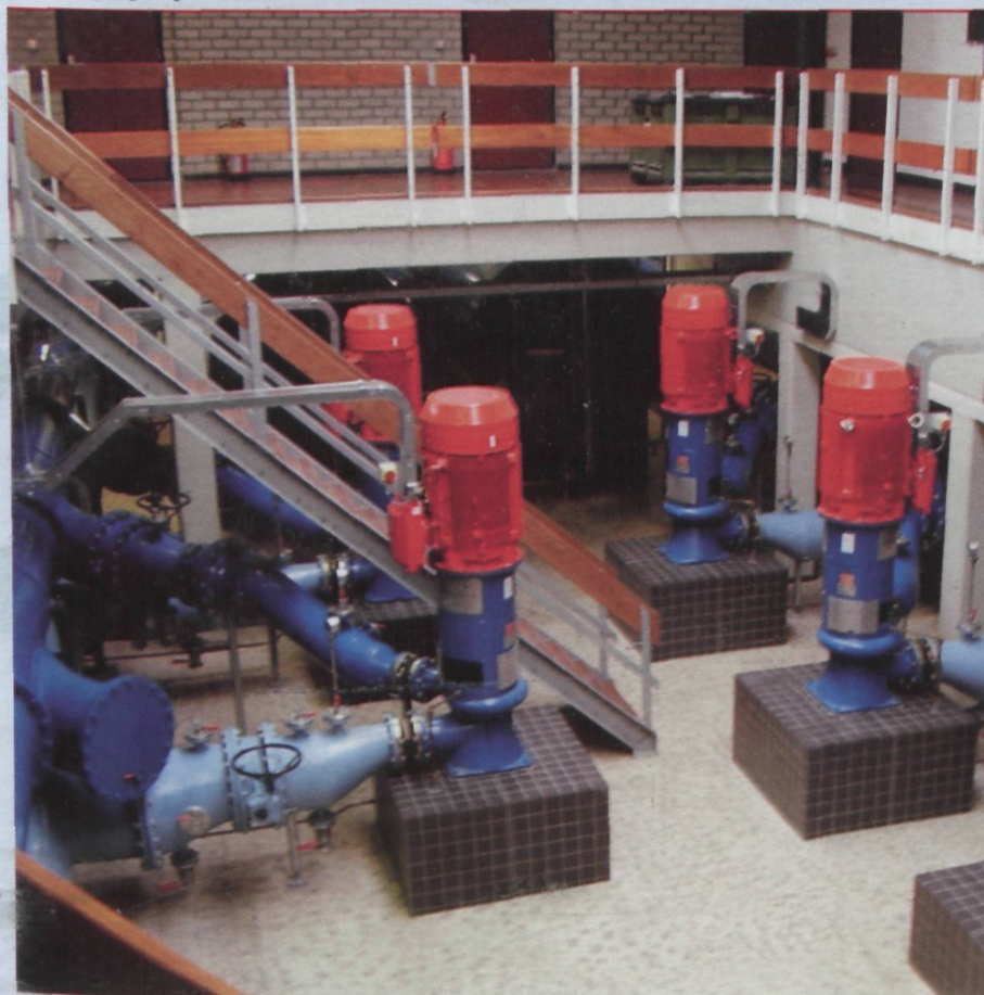
Transportpompen op waterwinstation Fledite.
