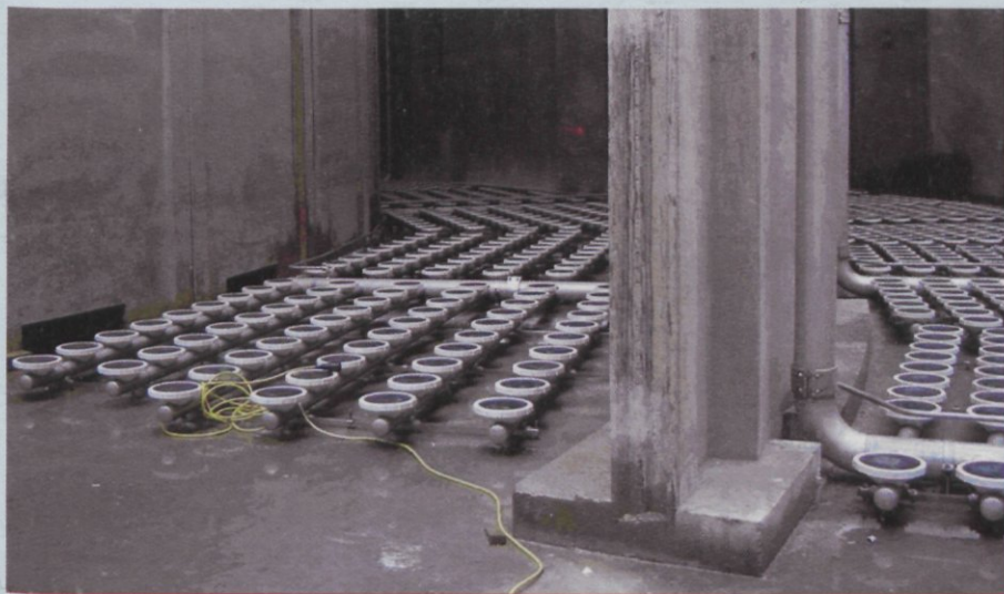
De beluchting van de nieuwe rioolwaterzuiveringsinstallatie in Amsterdam West.
